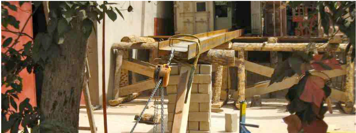
Ein 10m langer und 572 Kg schwerer H-Träger wird mit einem Kettenzug aus dem Container gezogen
