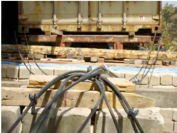
Container mit Drahtseilen an Bäumen befestigt
